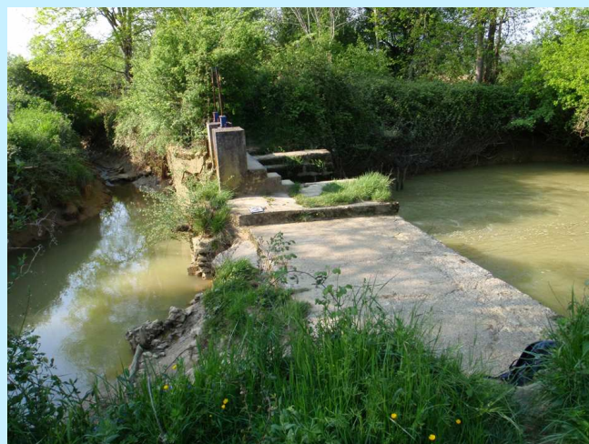
Exemple d'un seuil dégradé et délaissé
