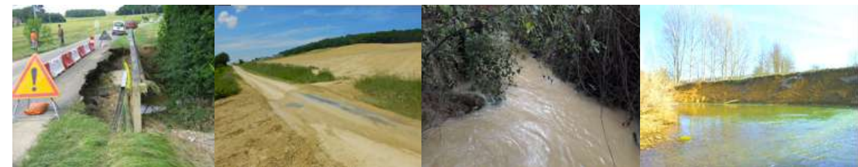
Dégâts sur les ouvrages
