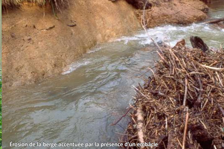
Les gros embâcles présentent un risque pour les ouvrages d'arts (ponts, routes, ...)
